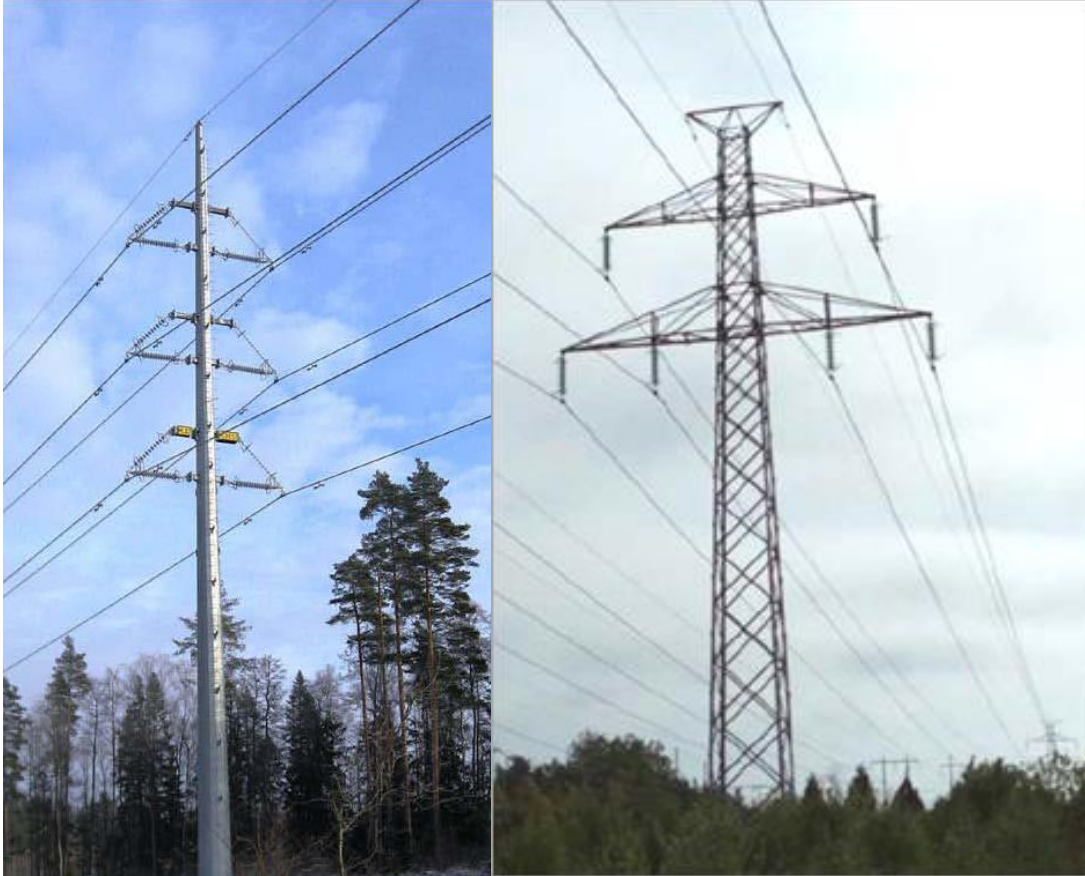
Figur 2.2. Exempel på olika typer av stålstolpar (rörstolpe till vänster, fackverksstolpe till höger)
