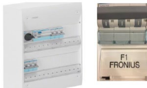
Bild 4 – Exempel på automatsäkringar
